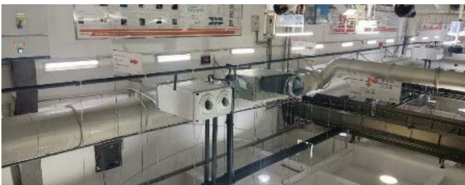
改造后的车间
